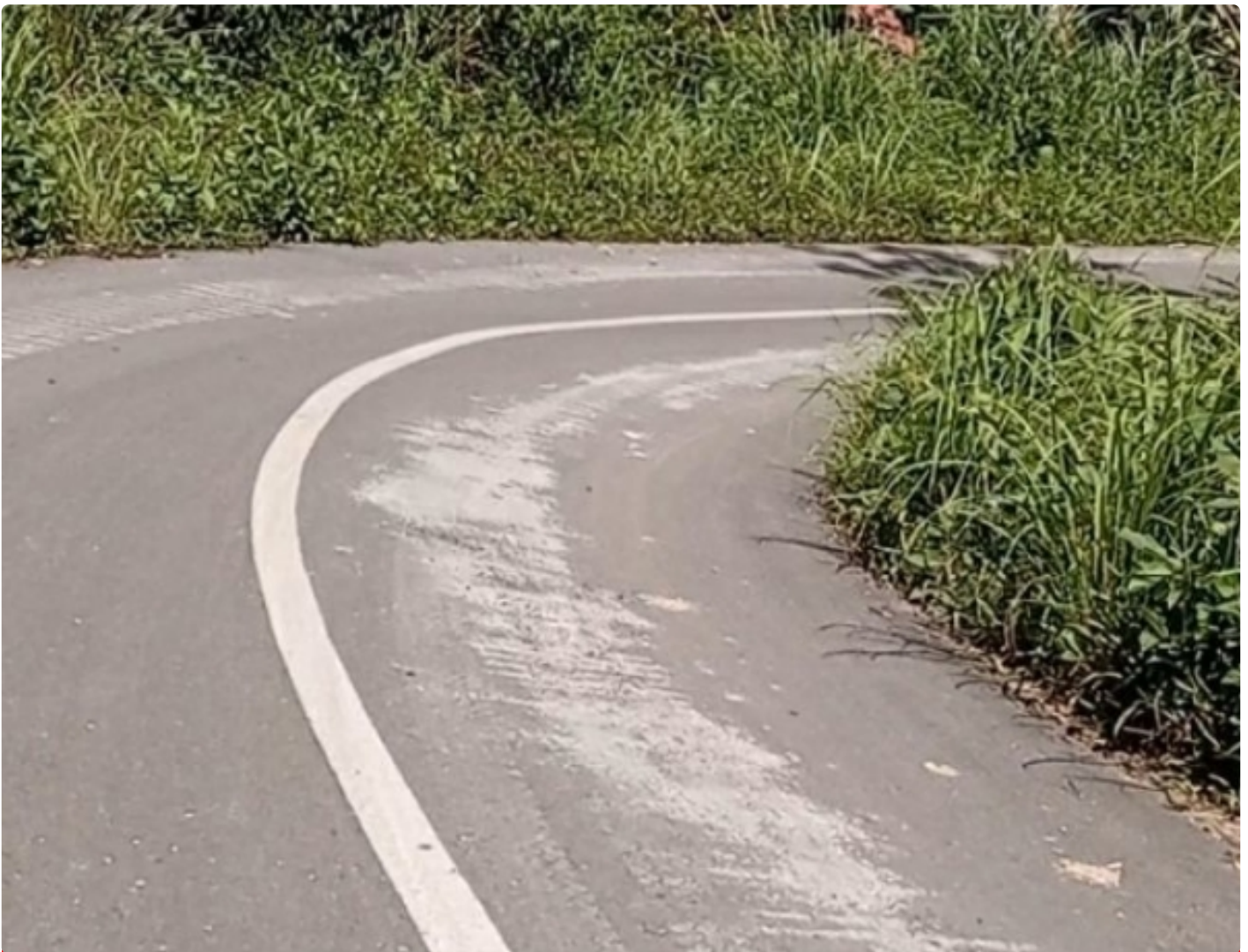
Aspal terlihat rusak yang diduga dilintasi Excavator di desa Pungut, kabupaten Kerinci-Jambi
